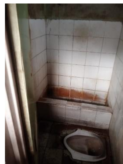
b. Kondisi salah satu toilet di Pasar Anyar
